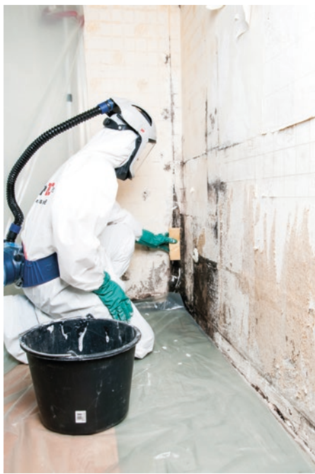
Feuchte Wände lassen Energiekosten ins Uferlose steigen – und stellen ein ernstzunehmendes Gesundheitsrisiko dar.
