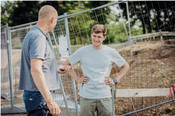
Rechtzeitig zu den Meisterschaften entsteht an der Rennstrecke ein neuer Zielturm. Bauleiter Paul te Neues überwacht den Baufortschritt.
