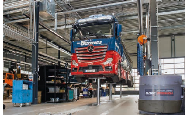
Lkw-Werkstatt mit Stempelhebebühne für komplett beladene Sattelzüge bis 95 Tonnen.
