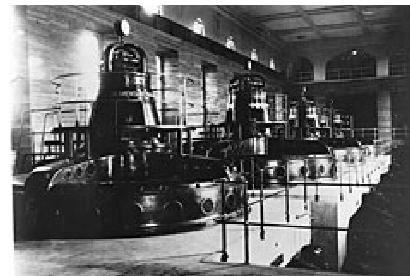
Francis-Turbinen im Wasserkraft- werk Raffelberg. Quelle: Stadt- archiv Mülheim
