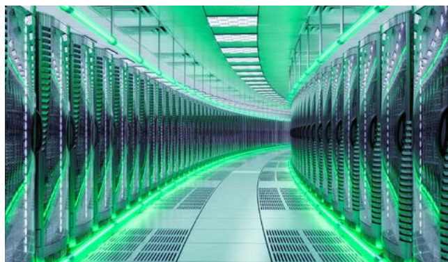
Die von Evonik genutzten zentralen Rechenzentrumsleistungen verwenden ausschließlich grünen Strom.
