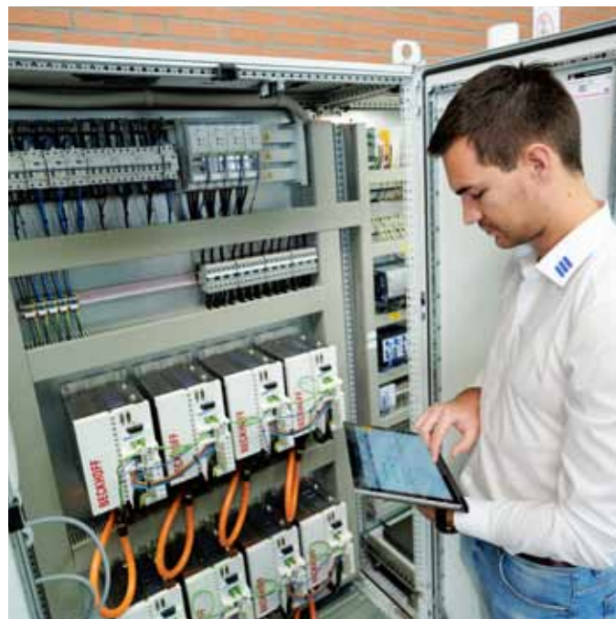
Doktorand Robin Heidel überprüft die Antriebstechnik in der Schaltzentrale. Alle Daten kommen hier zusammen.
