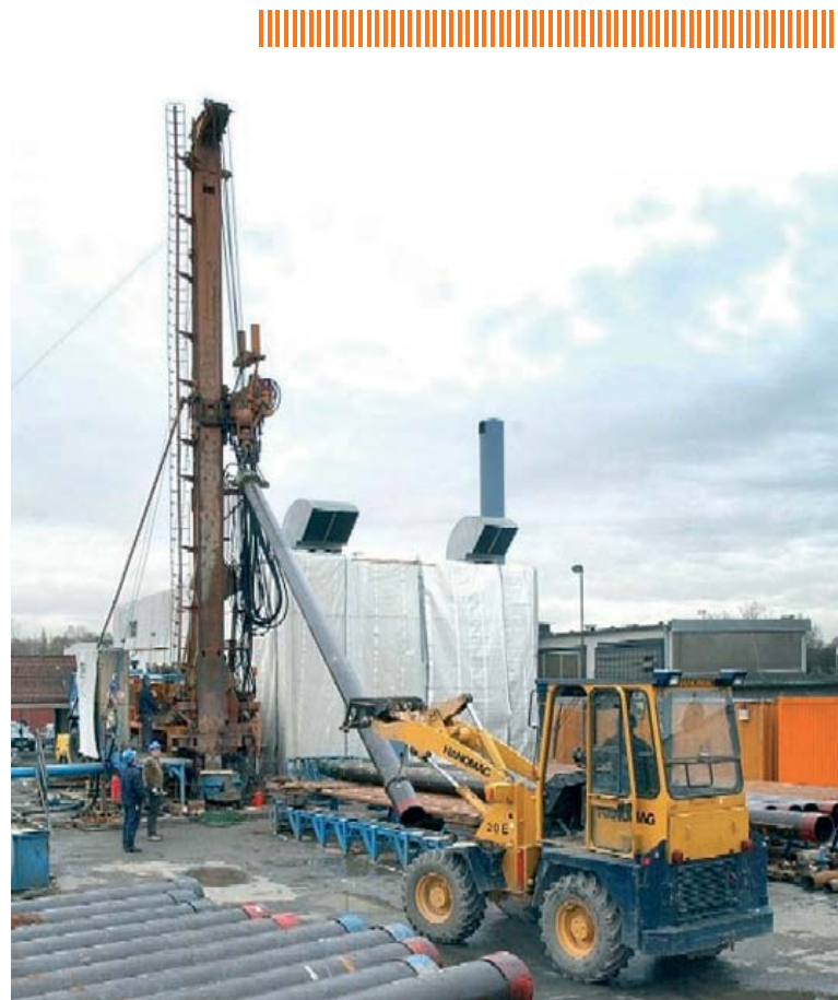
Grubengasbohrung an der Gasentspannungsanlage "Am Trimbuschhof" Foto: Stadtwerke Herne
