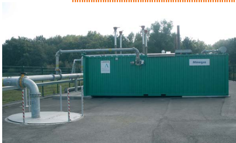
Grubengasbohrung Ickern-Methan 1 mit angeschlossener Grubengasanlage
