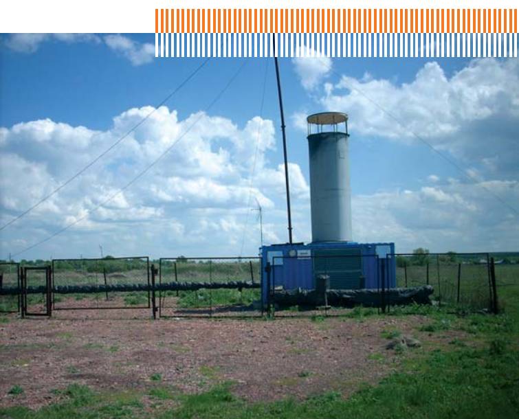
Geregelte, geschlossene Fackelanlage (5 MW thermisch) mit integriertem Grubengasverdichter auf dem Bergwerk Chertinskaya in Belovo in der Kuzbass-Region in Sibirien
