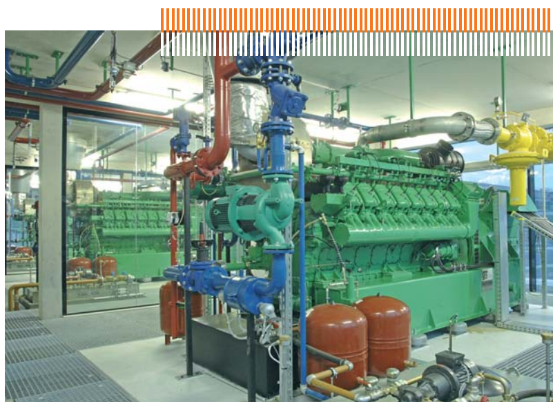
Gasmotor der Grubengasanlage auf dem Standort Blumenthal 3/4 (Minegas GmbH)
