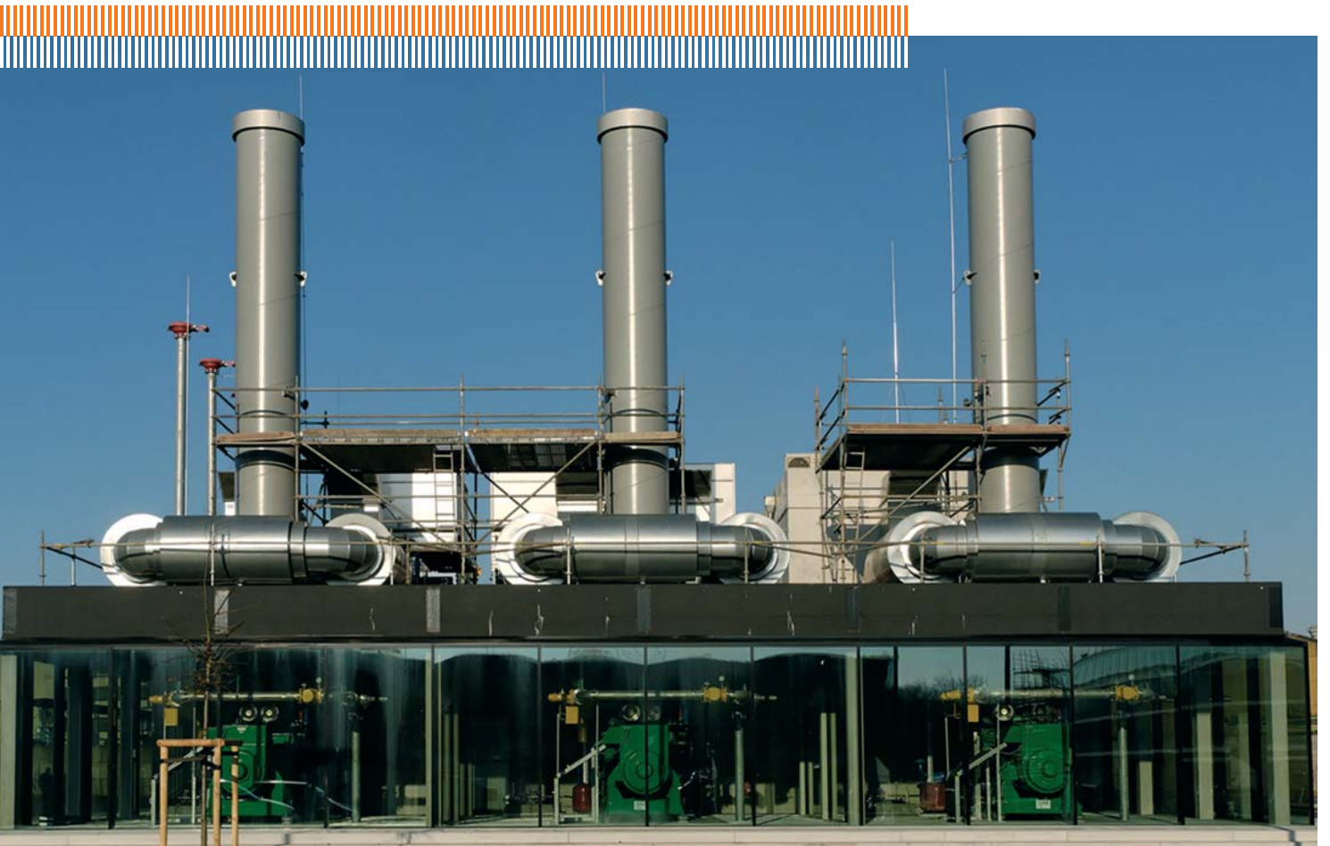
Grubengasanlage auf dem Standort Blumenthal 3/4 (Minegas GmbH)
