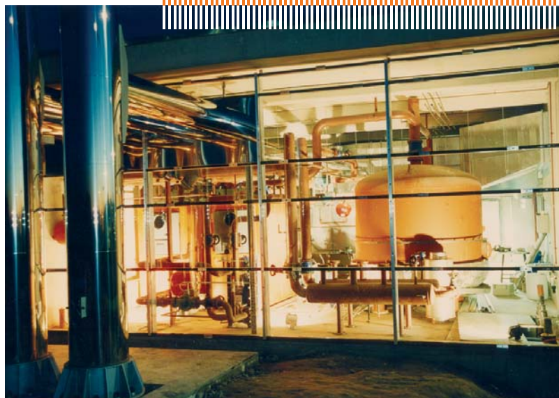
Kesselhaus mit Spitzenlastkessel der ersten Bauphase
