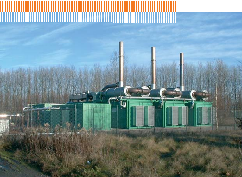
Grubengasanlage auf dem Standort Kurl 3 (Minegas GmbH)
