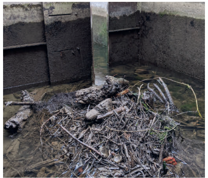
Bild 18.5: Totholzansammlung in einem Becken Fig. 18.5: Accumulation of deadwood in a tank
