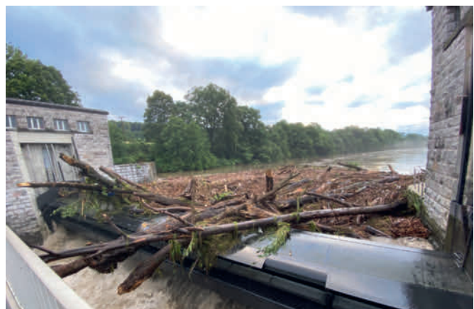
Bild 17.1: Ansammlung von Treibgut an der Wehrklappe des Wasserkraftwerks Echthausen (AWWR) Fig. 17.1: Flotsam accumulating at the weir gate of the hydropower station Echthausen (AWWR)
