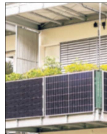
Am Balkongeländer kann eigener Solarstrom gewonnen werden.
