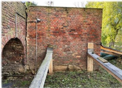
Zu sanierende Mauerecke
