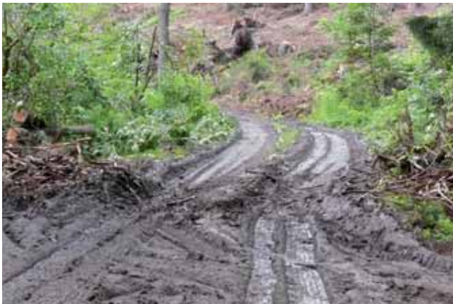
Instandsetzungsbedürftiger Weg nach intensiver forstlicher Nutzung.
