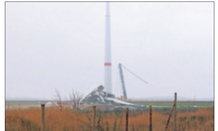
Die Windkraftanlage liegt auf dem Boden. Die anderen fünf Windräder sollen Stück für Stück demontiert werden.
