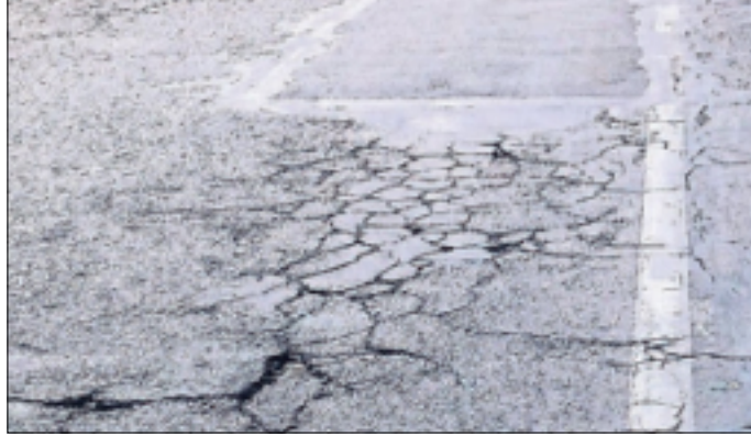
Manche Straße in der Schloss-Stadt ist dringend sanierungsbedürftig. Fotos: Archiv.
