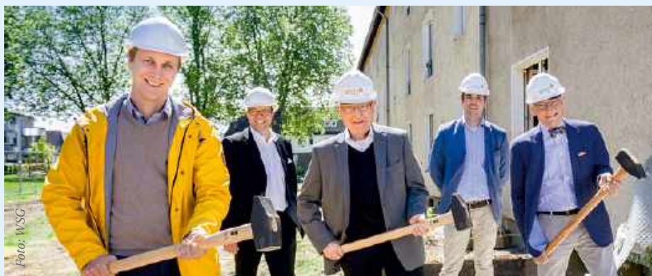
Monheim am Rheins Bürgermeister Daniel Zimmermann, WSG-Aufsichtsratsvorsitzender Bernhard Greßmeyer und WSG-Geschäftsführer Gisbert Schwarzhoff (v. l.) beim ersten Hammerschlag für den nächsten Bauabschnitt der „Platanenhöfe“
