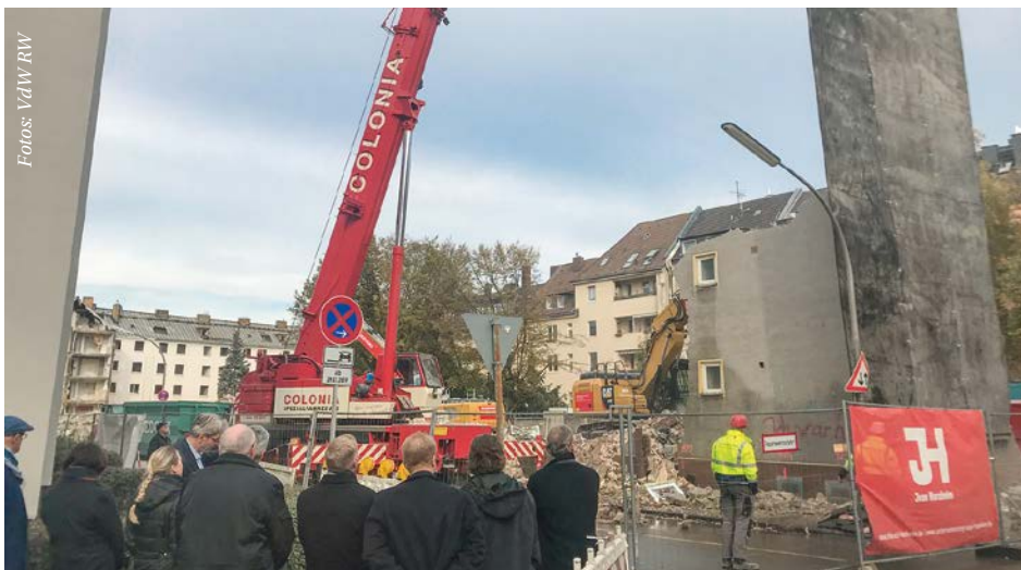
Im Baufeld an der Loesstraße werden alte Wohnungen abgerissen, damit 96 neue geförderte Wohnungen entstehen können
