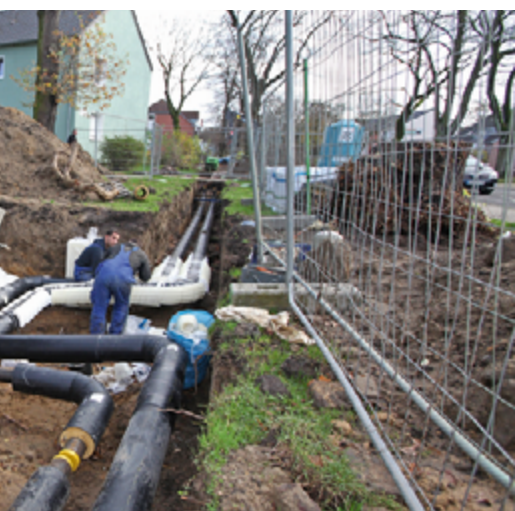
Erarbeiten sind notwendig
