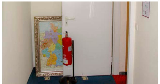
Bei einer Brandschau wird auf jedes Detail geachtet: Rauchschutztüren dürfen nicht aufgestellt sein
