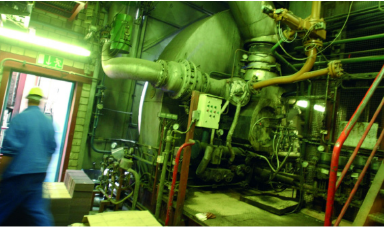
Drehrohrofen für die Verbrennung von Industrieabfällen. Rund 18 Prozent der in Nordrhein-Westfalen entsorgten gefährlichen Abfälle werden verbrannt.
