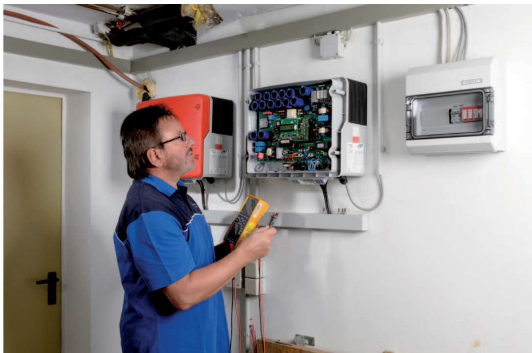
Prüfung eines Wechselrichters einer PV-Anlage in einem Einfamilienhaus.
