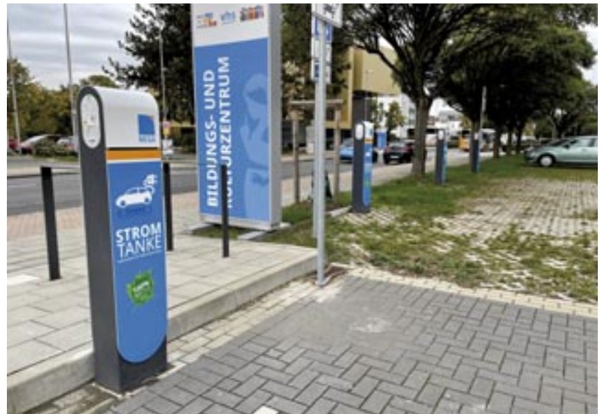
Am Parkplatz von Bildungs- und Kulturzentrum stehen fünf E-Ladestationen mit je zwei Ladepunkten.
