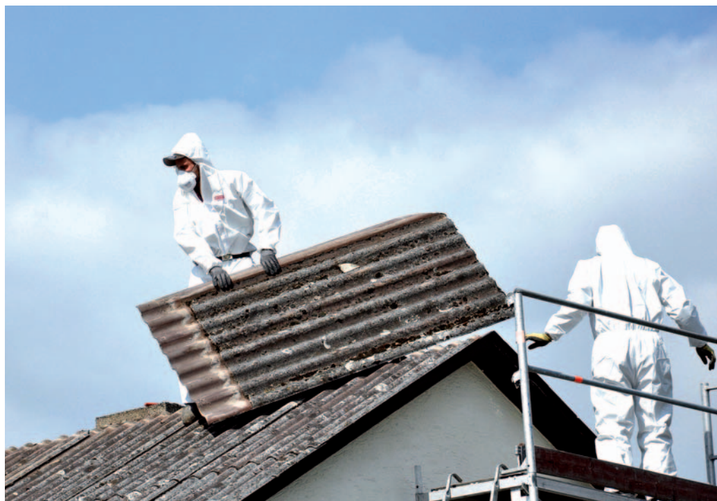
Die Sanierung asbestbelasteter Dächer muss unbedingt durch Fachleute geschehen, da das Material gesundheitsgefährdend ist und nur auf entsprechenden Deponien entsorgt werden darf. Foto: epr/Luxmetall
