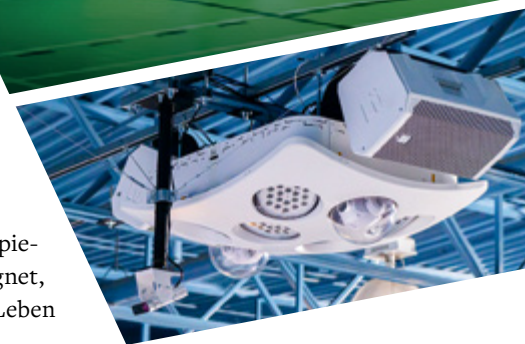
Die digitale Infrastruktur von LÜ ist extrem flexibel einsetzbar. Beamer, Kamera, Licht und Soundsystem – alles in einem.
