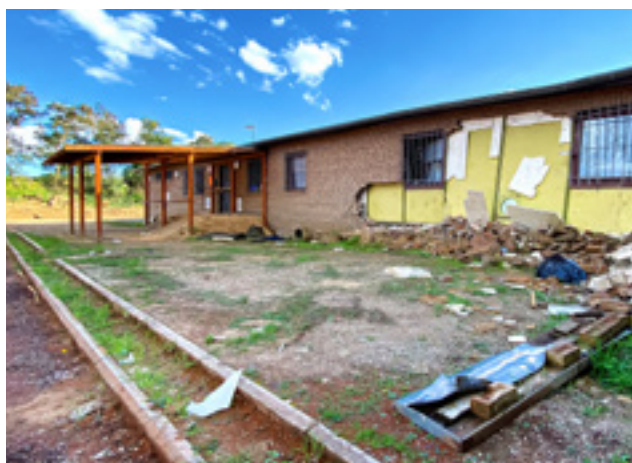
Die Schäden am Vereinsheim der Sportschützen Odendorf in Swisttal sind enorm und noch gar nicht abschätzbar
