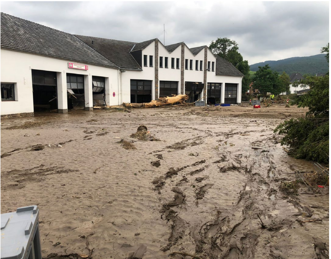
Auch die Freiwillige Feuerwehr blieb von Zerstörungswut des Hochwassers nicht verschont
