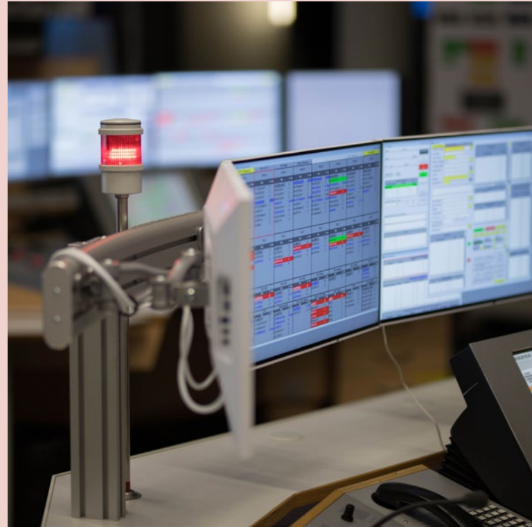
Ein Einsatzleitplatz in der Leitstelle der FwDus
