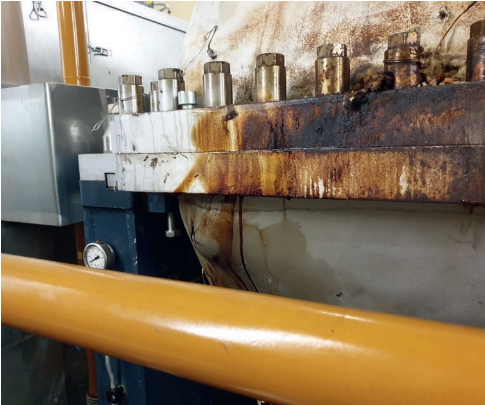
Der Totalschaden der Dampfturbine vom Januar 2020 stellt eine erhebliche Belastung für das wirtschaftliche Jahresergebnis der WFA E dar. Erst Ende Oktober konnte die neue Turbine in Betrieb gehen.
