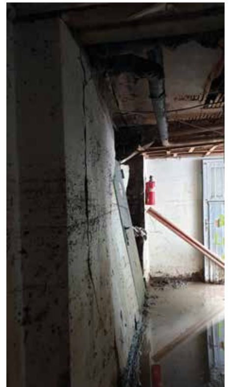
Innenwand bei einseitigem Wasserdruck bei einem Haus in Bad Neuenahr
