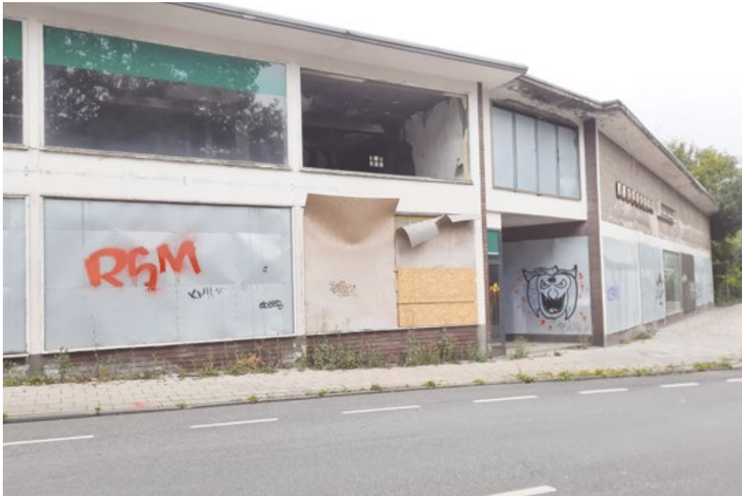
Hier flog unlängst ein ganzes Fahrrad aus dem Fenster. Zunehmend wird die Bauruine zur Gefahr für Fußgänger, Rad- und Autofahrer.
