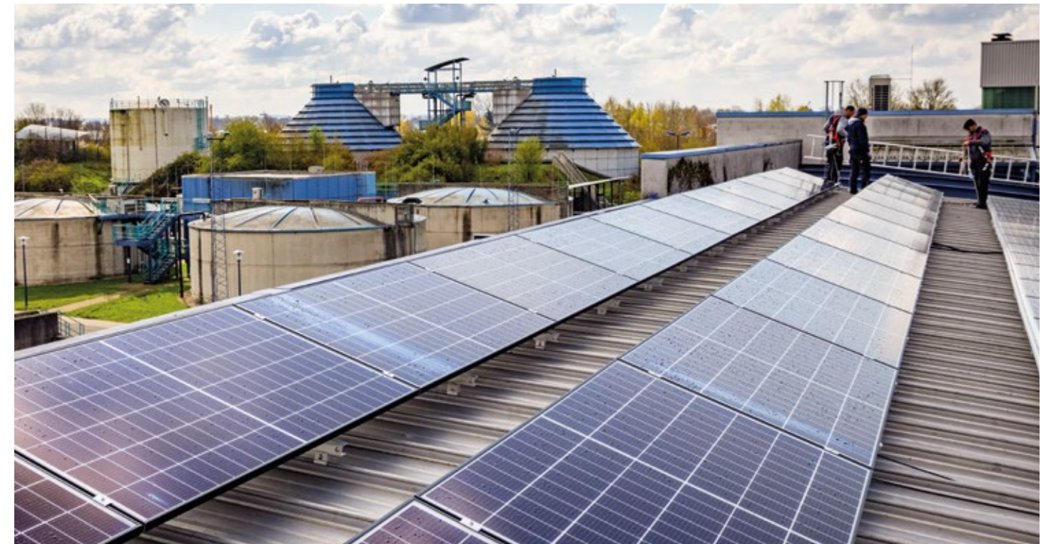
64 Energie Neue Photovoltaikanlage
