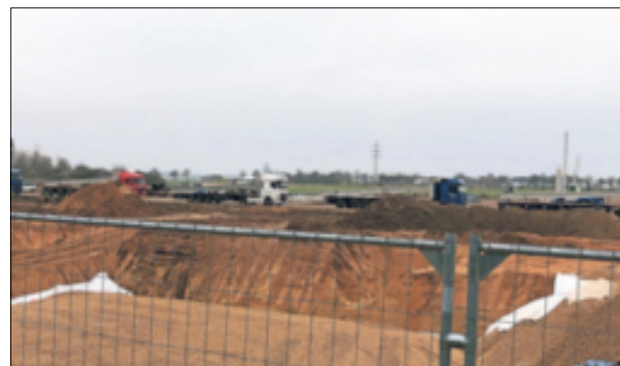
Zahlreiche Lkw verlassen tagtäglich die Baustelle und bringen Schlamm auf die umliegenden Straßen.
