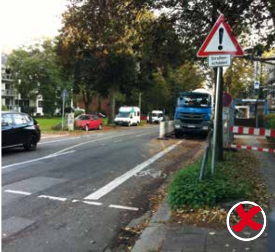
Bild 14 | Arbeitsstelle auf Radfahrstreifen ohne Absicherung
