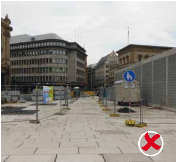
Bild 3 | schlecht sichtbare Absperrung
