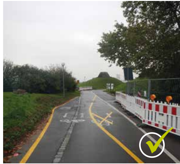
Bild 4 | gut sichtbare Absperrung und Gelb-Markierung
