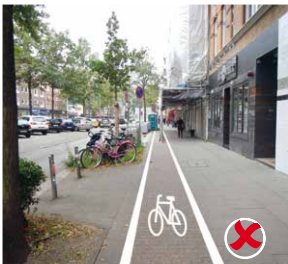
Bild 12 | Gerüst auf Radweg mit schlecht sichtbarer Sicherung
