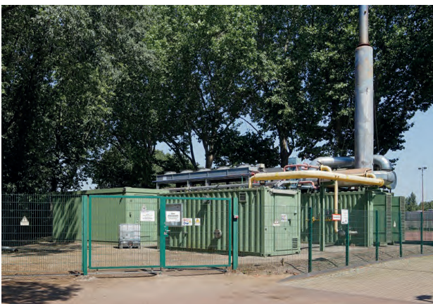
Bild 2.1 – Grubengasverwertungsanlage (Quelle: Friedhelm Krischer)
