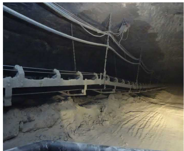
Bild 7.3 – Hauptbandstraße vor Sanierung der Sohle
