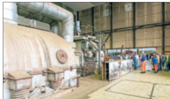
Der Abschied wurde stillecht in der Maschinenhalle der Blöcke P und Q gefeiert.
