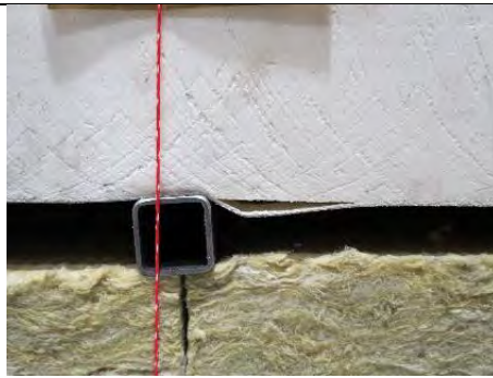
Abbildung 4-179: Lokale Verformungen und Delamination der inneren Deckschicht Figure 4-179: Local deformations and delamination of the inner face layer
