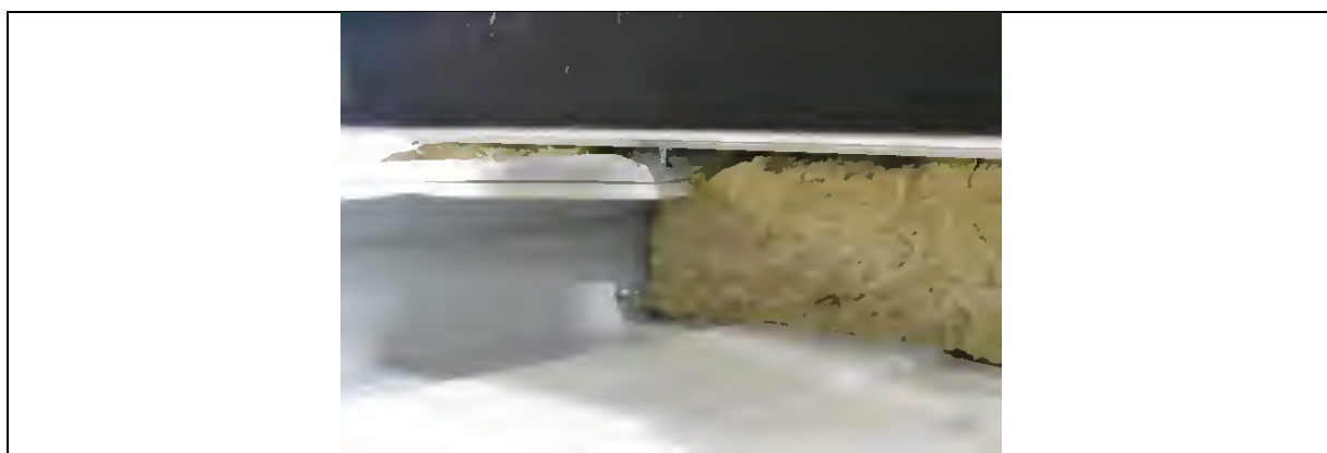
Abbildung 4-135: Eindrücken des schmalen Gurtes durch fehlerhafte Montage Figure 4-135: Denting of the small flange due to faulty installation
