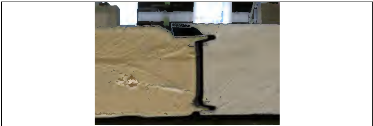
Abbildung 4-157: Aufklaffende Längsfuge Figure 4-157: Gaping longitudinal joint
