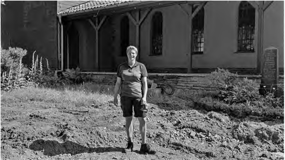
Ausschachtarbeiten und Vorbereitungen für den Wegebau laufen. Carolin Schlesiger zeigt die Fläche, die zur Zeit für ein neues Urnenwahlfeld aufbereitet wird.
