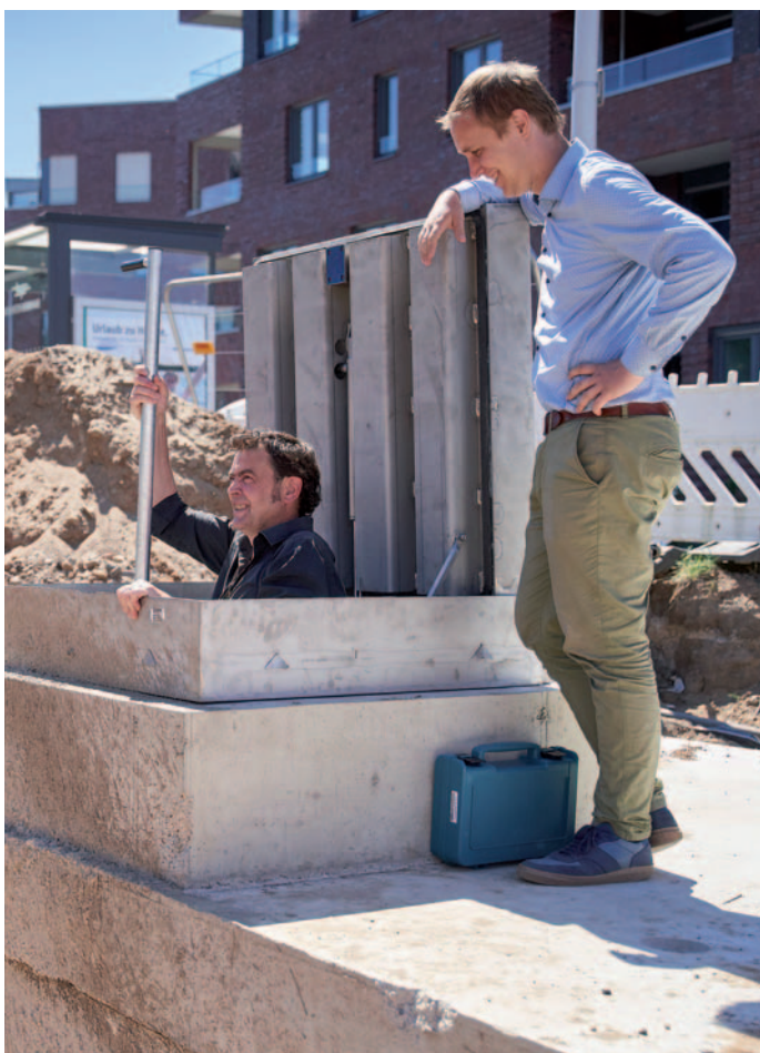
Auch der Technikraum zu Steuerung der Düsen wird unter der Erde verborgen.
