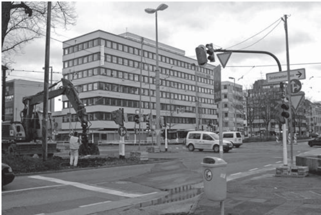
Die Umbauarbeiten an der Kreuzung Ostwall/St.-Anton-Straße für eine ebenerdige Fußgängerquerung haben begonnen.
