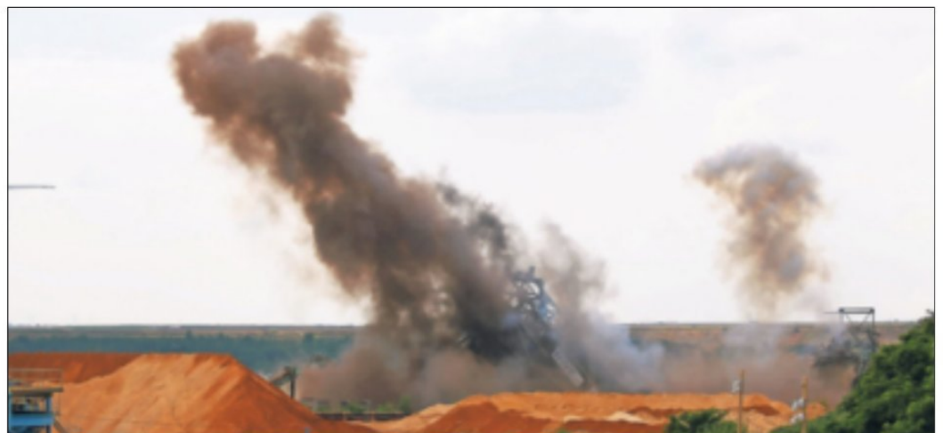
Nach der Sprengung (die wichtigsten Phasen sind hier in den drei Bildern zu sehen) blieb von dem Bagger 271 nur noch der so genannte „C-Bogen“ aufrecht stehen. Fotos: Gerhard Müller
