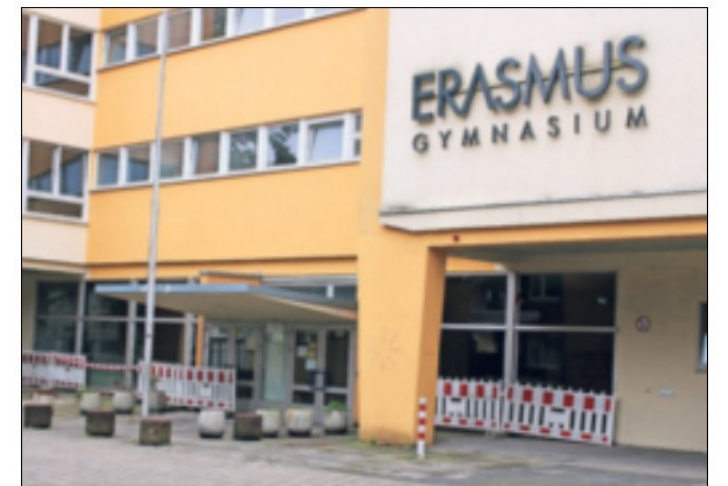
Das aus den 50er Jahren stammende Eingangselement des Erasmus-Gymnasiums ist altersbedingt marode und muss saniert werden. Foto: gpm.
