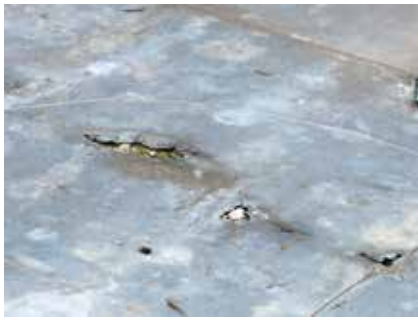
Alte Bleieindeckung: dünne Stellen bzw. Löcher durch unterseitigen Weißrostbefall; 2014 (Abb. 2).
