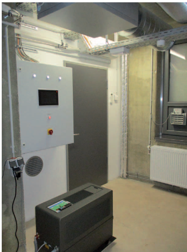
Technikraum mit Klimageräten (Foto: Johannes Röder)
