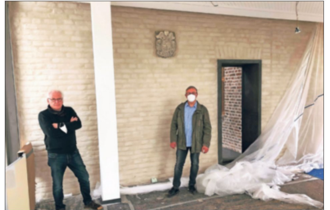
Helmut Coenen und Bauleiter Bernd Blatt (rechts) vor der ehemaligen Außenwand des „Altes Pastorats“, die im Neubau dem Pfarrsaal eine besondere Atmosphäre einhaucht. Rechts der Eingang zur zentralen Küche. Der neue Durchbruch wurde durch die farbige Beton-Optik deutlich gekennzeichnet. Fotos: Gerhard Müller
