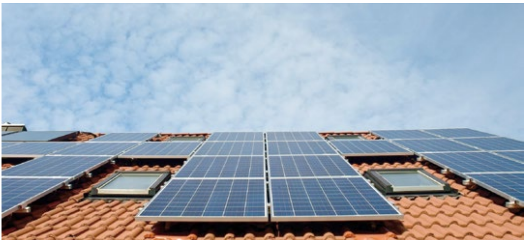
Eine Solarthermieanlage erzeugt thermische Energie, also Wärme. Foto: Pixabay_ulleo
