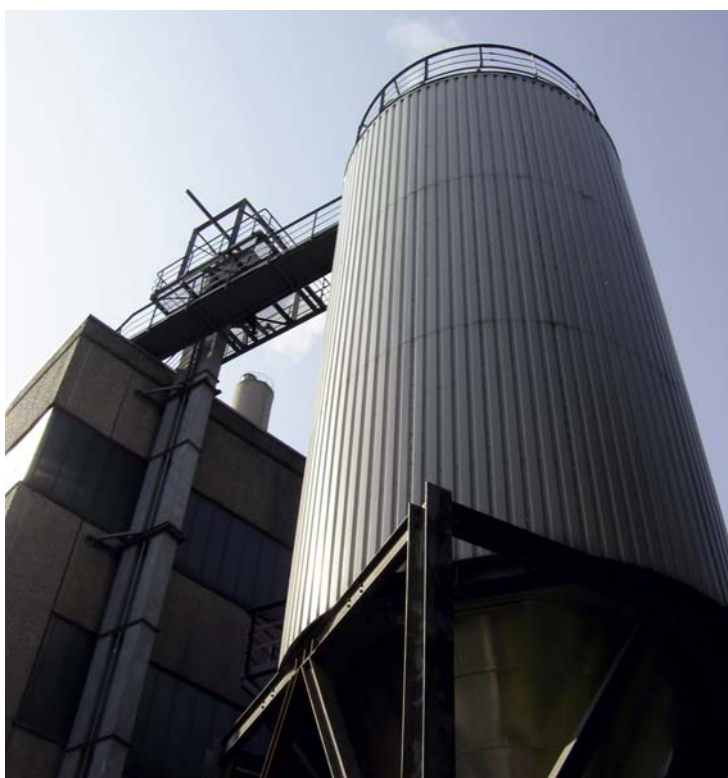
Aschesilo Schlammverbrennungsanlage Buchenhofen
