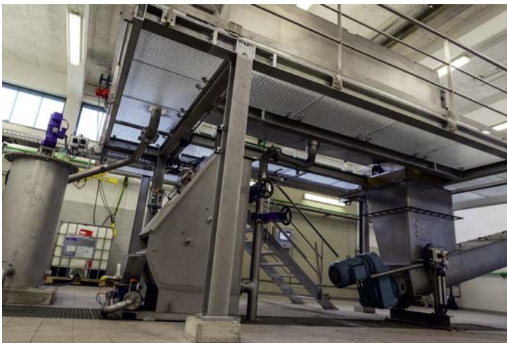
Kläranlage Schwelm: neue Schneckenpresse
