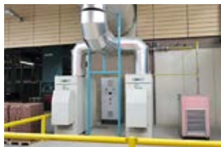
Mikrogasturbinen-BHKW der Firma Capstone.
