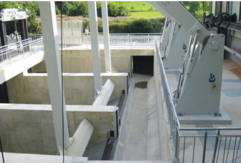
Ansicht der Schutzrechen und der Abstiegsrinne für Fische vor Inbetriebnahme der Pilotanlage
