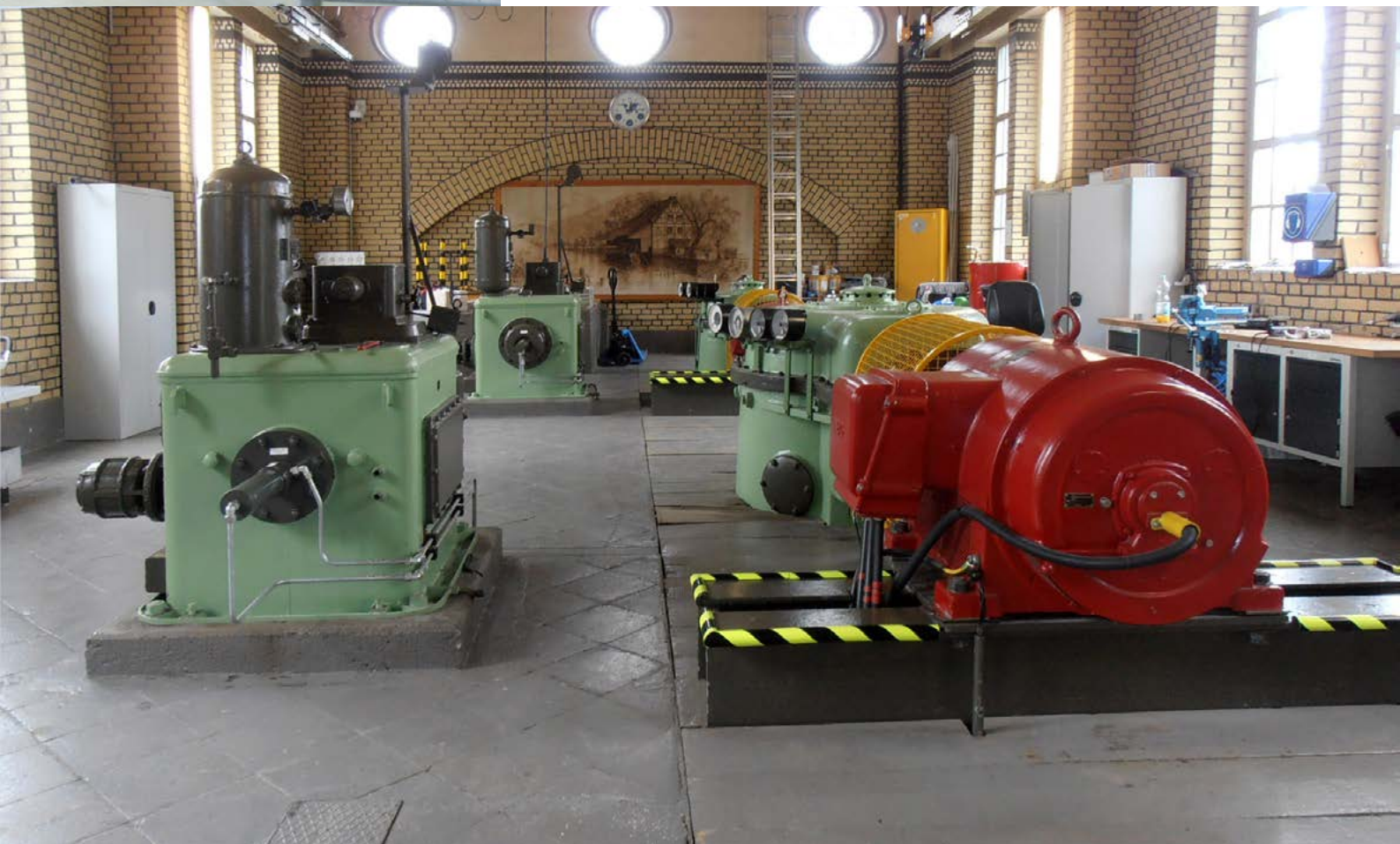
Maschinenhalle der Wasserkraftanlage mit Generatoren
