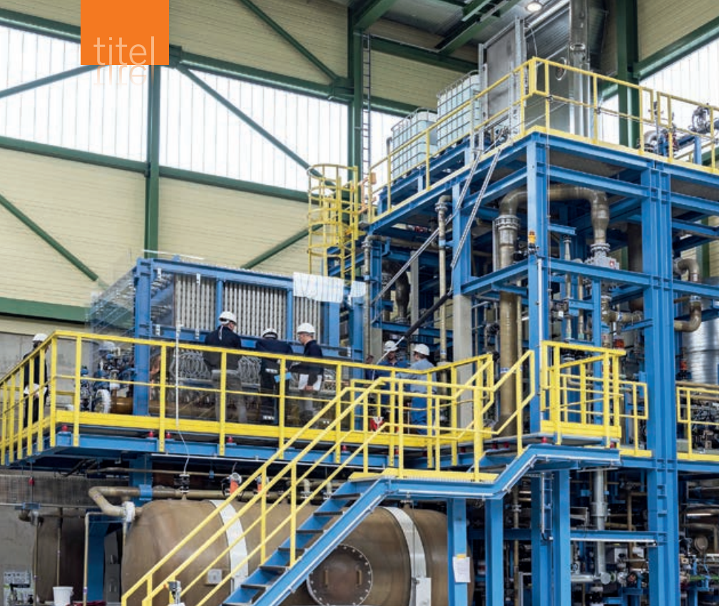
Sieht kompliziert aus, hilft aber bei der Energiewende: In einem Elektrolyseur wird Wasserstoff erzeugt.
