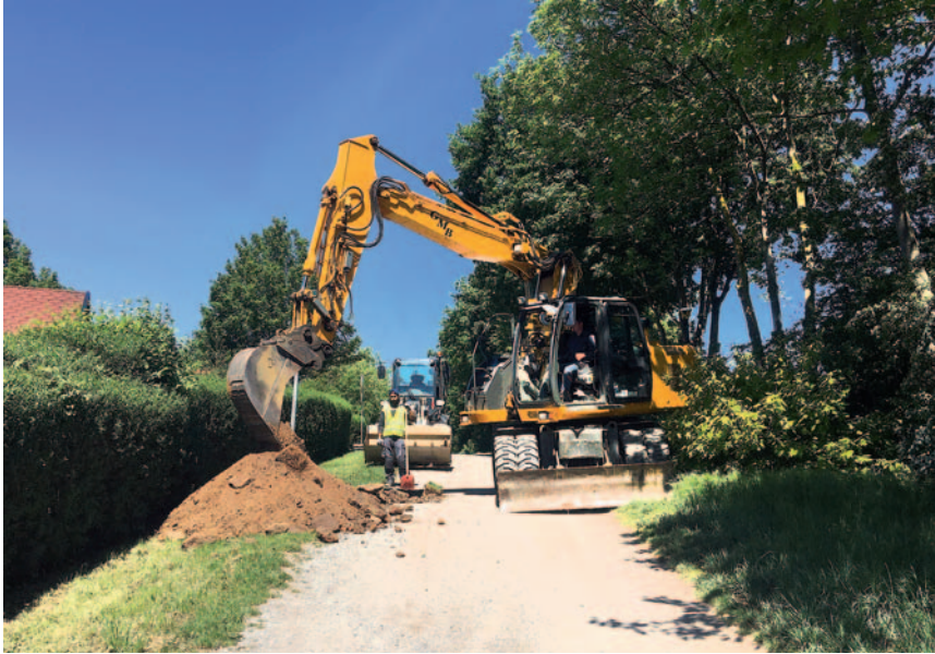
Die Bagger sind da! Auf dem Schotterweg zwischen den Kleingärten in Baumberg und Hellerhof haben die Bauarbeiten am Monheimer Radschnellweg begonnen.
