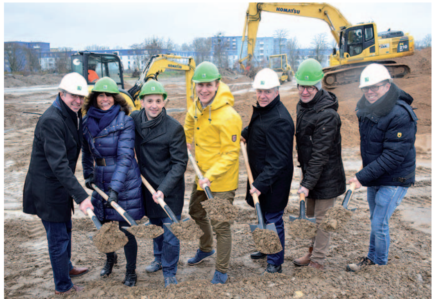
„Unter den Linden“: Beim symbolischen Spatenstich nahmen unter anderem Bürgermeister Daniel Zimmermann, „nesseler“-Geschäftsführer Karl-Peter Arnolds, Architekt Harald Wenne-mar, Sabine Noll und Michael Lobe tatkräftig die Spaten in die Hand. Foto: Norbert Jakobs
