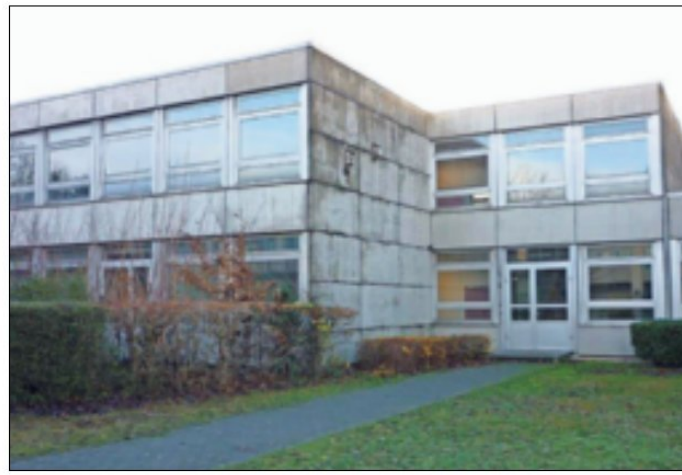
So sahen die heruntergekommenen Fassaden vor der Sanierung aus.
