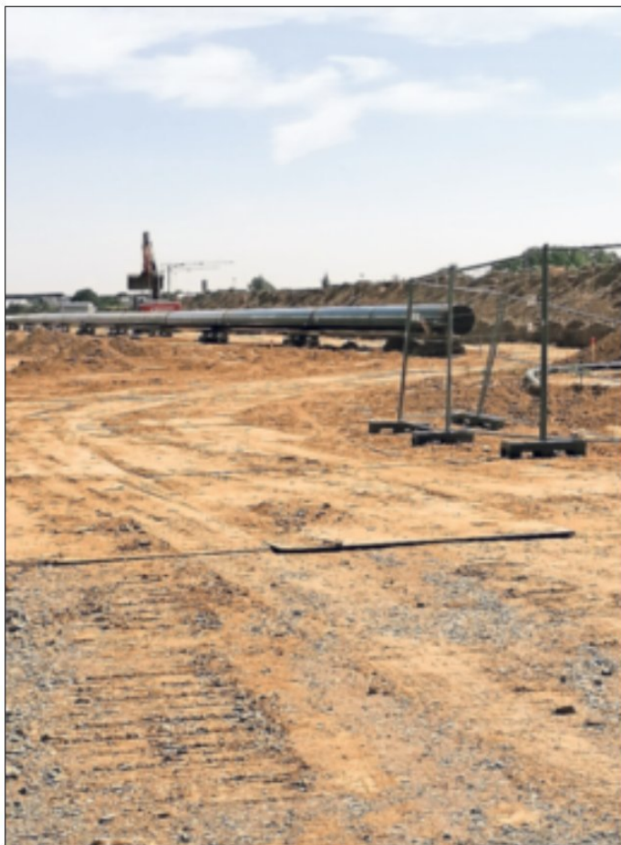
Die Bauarbeiten für die „Zeelink“-Pipeline liegen voll im Zeitplan. Foto: J. Schäfer
